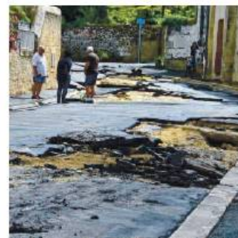
VERNOU-SUR-BRENNE. Le ruissellement a été d'une telle puissance que la rue Neuve a été complètement dévastée.
