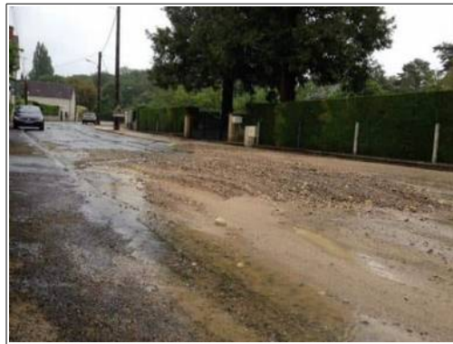
Chisseaux : des dégâts importants.
